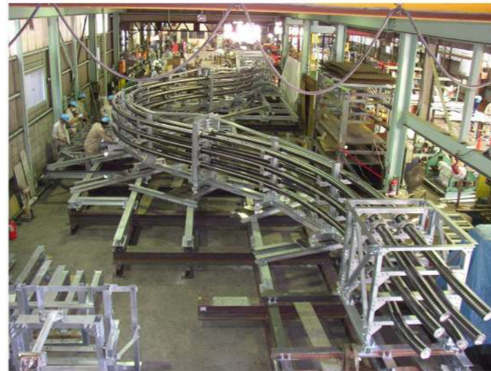
■ ケーブル可動架台
