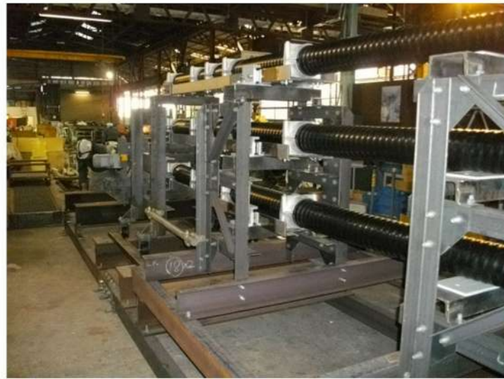
■ ケーブル架台
